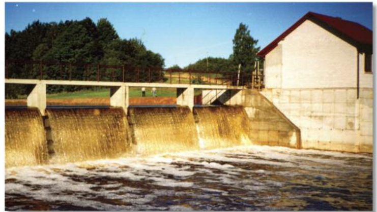
Malá vodní elektrárna Vadagai (Litva) Small hydro power plant Vadagai (Lithuania) МГЭС Вадагаи (Литва)
