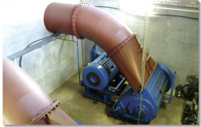
Dvě turbíny Bánki B600/1500 v MVE Skuodas (Litva) Two turbines Bánki B600/1500 - Hydro power plant Skuodas (Lithuania) 2 x турбина Банки Б600/1500 Скуодас (Литва)
