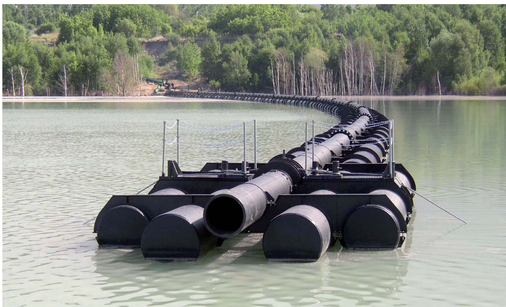
Plovoucí naplavovací potrubí strusky pro odkaliště Chemopetrol Litvínov (ČR) Floating alluvial pipeline for transport slag to settling pit of Chemopetrol Litvínov (Czech Republic) Пловущий намывный трубопровод Хемопетрол Литвинов (ЧР)
